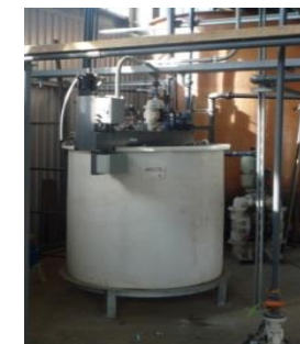
Збірник стоків ділянки хімічного травлення металу
